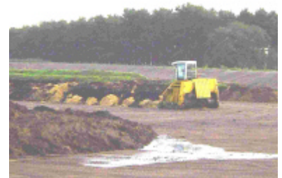
Klärschlammbehandlung in Nordhorn
